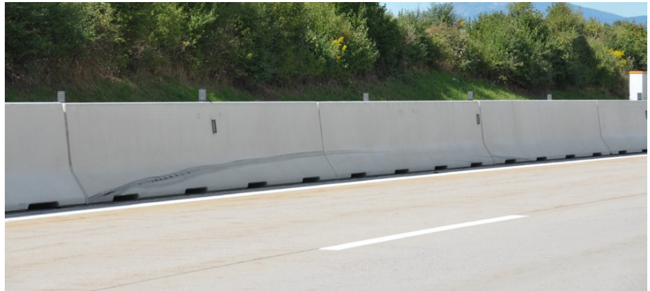
Nötningsmärken, men systemet är inte skadat
